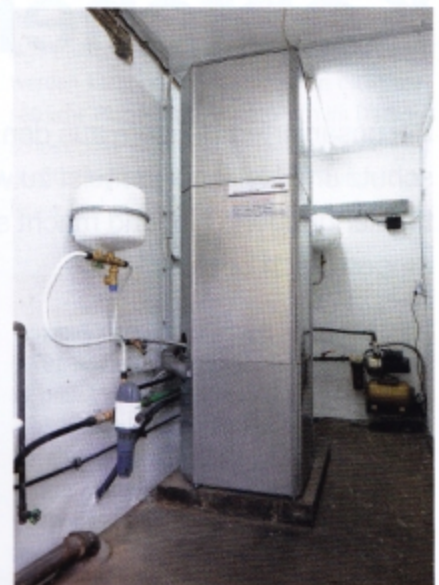
Der Brauchwasserspeicher und das Innengerät der Wärmepumpe benötigen nicht viel Platz im Keller.
