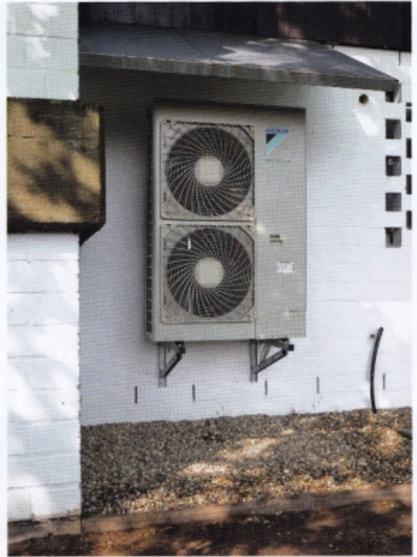
Die Wärmepumpe „Altherma LuvIType“ von Daikin beheizt mit einer Leistung von 16 kW die etwa 240 m 2 große Wohnfläche des Wohnhauses.
